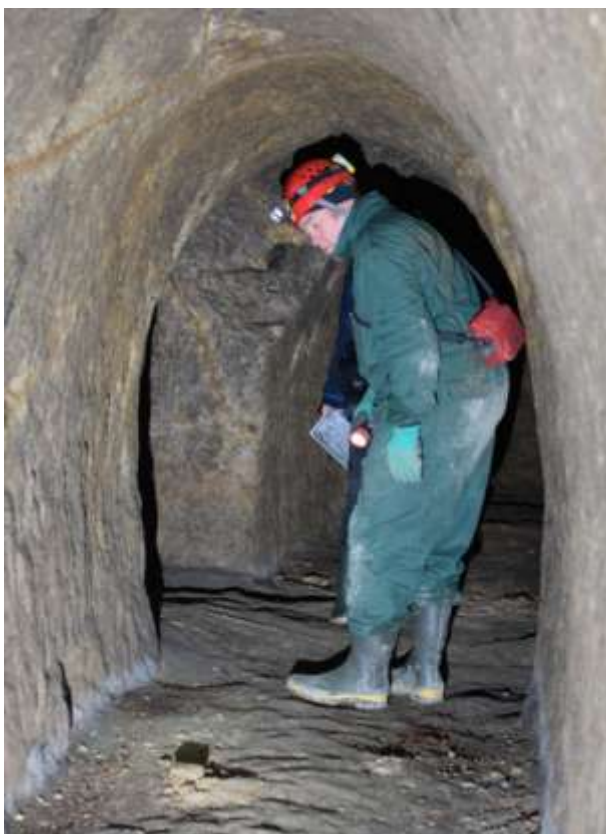
Gangkreuz mit Wasserstandsmarke flach über der Sohle (Foto: Alvaro Aguilera)
